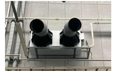
高崎支店 工場エアコン
