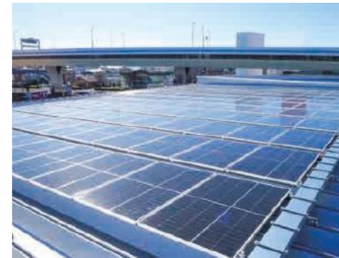
浦和支店 太陽光発電システム
